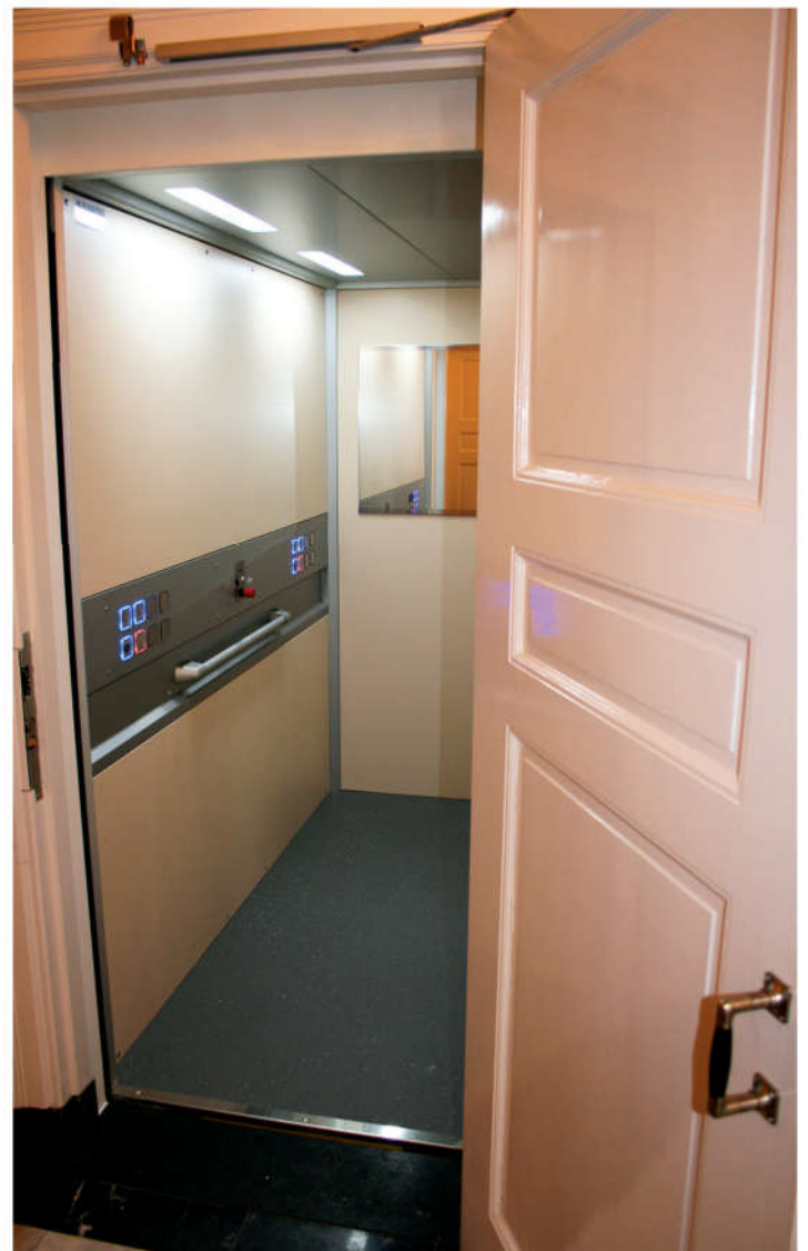
De nieuwe lift is fraai in een oude toiletruimte met stijlvolle deur opgenomen.
