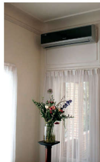
De installatietechnische voorzieningen zoals airco en audiovisuele apparatuur heeft een opvallende plek gekregen.
